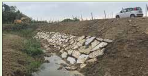
in collaborazione con il Consorzio Bonifica Cellina Meduna, ripresa frane lungo l'affluente del canale Corella, tra i comuni di Meduna di Livenza e Pasiano di Pordenone. Consorzio Piave "Soggetto attuatore" designato dal Commissario Straordinario delegato per il rischio idrogeologico nel Veneto, per il progetto "Interventi di sistemazione delle sponde dei canali consorziali" per l'importo di 900.000,00 euro
