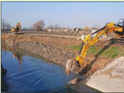
Ripresa frane lungo il canale Bidoggia a Rustigné, località in comune di Oderzo
