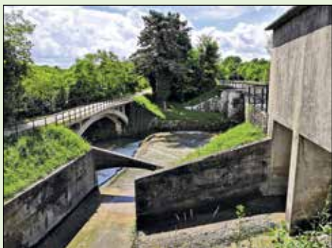
Manutenzione straordinaria del ponte-canale del canale Brentella di Pederobba sul torrente Curogna per infiltrazione d'acqua importanti.
