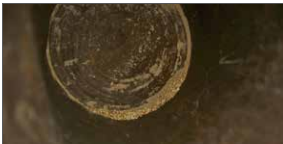
Contenitore per il mangime NON correttamente pulito. Presenza di materiale residuale sul fondo
