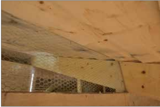
Particolare del soffitto con rete protettiva per impedire l'accesso ai roditori
